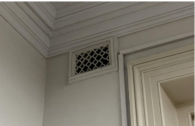
I. VENTILATION GRILLE
